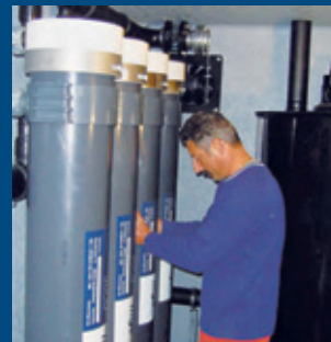
Die Anlage ist in standardisierten Containern untergebracht.
