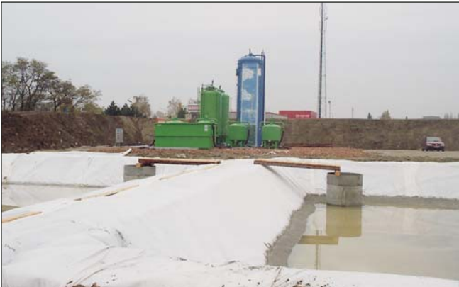
Die Vorsedimentationsbecken sind in Erdbau-Folientechnik ausgeführt.
