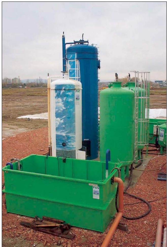
Von einem Vorsedimentationsbecken mit einem Volumen von 400 m 3 wird das Wasser in einen 20 m 3 fassenden Druckerhöhungsbehälter gefördert. Von dort wird es durch die Filtrations- und Nassadsorptionsstufe gepumpt.
