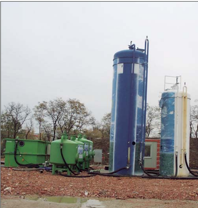
Das Wasser fließt zuerst über Kiesfilter (Behälter im Vordergrund). Danach strömt es durch die Wasseraktivkohlefilter (Behälter im Hintergrund). Alle Behälter sind mit Rückspülanschlüssen ausgestattet.
