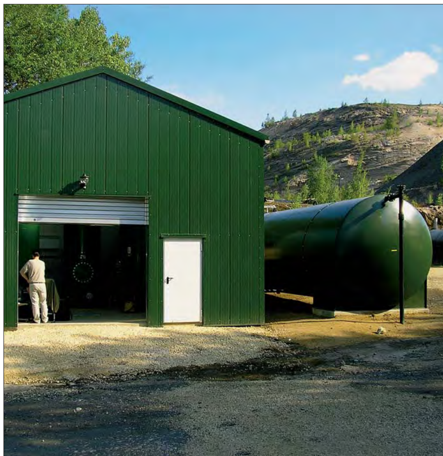
Der vorgeschaltete Ausgleichstank kompensiert den schwankenden Sickerwasseranfall. Der Füllstand im Tank wird kontinuierlich gemessen und dient als Grundlage für die Steuerung des Anlagen durchsatzes.
