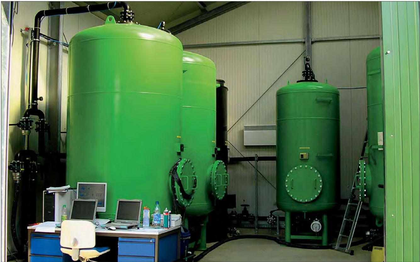
Die Anlage wird über eine SPS gesteuert. BAUER Umweltgruppe führt den kompletten Aktivkohle-Service durch.
