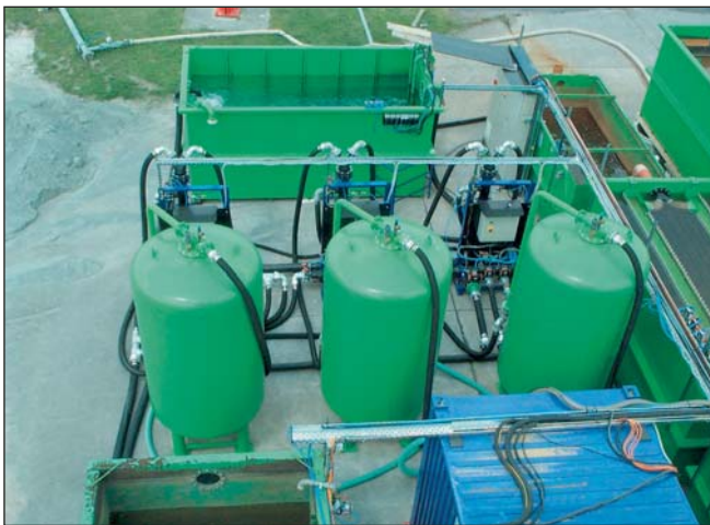
Das vorgereinigte Wasser durchläuft eine parallel installierte Mehrschichtfilteranlage mit automatischer Rückspülung, in der feine Schwebstoffe, an die PAK's gebunden sind, zurückgehalten werden. Damit wird die Standzeit der Aktivkohle verlängert.
