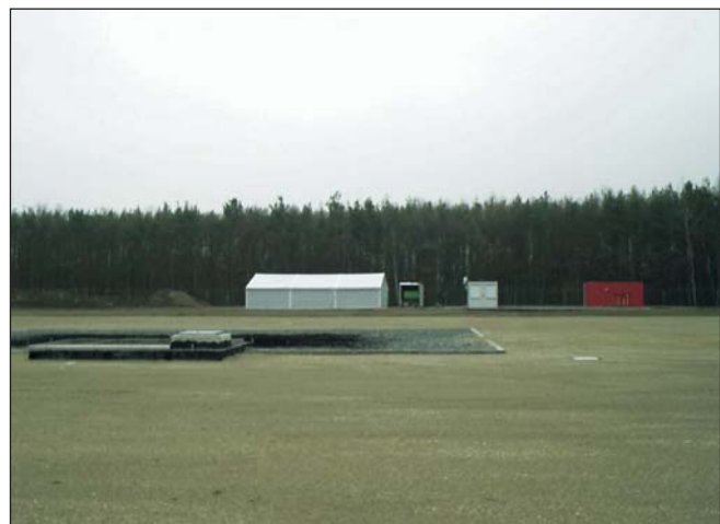
Die Anlage zur Grundwasser- und Bodenluftsanierung ist aufgrund der zu erwartenden abklingenden Schadstoffkonzentration dreiphasig ausgelegt.
