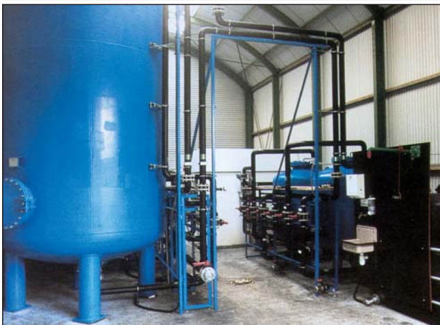
Aufbau der Opfer- und Hauptadsorptionsfilter und komplett installierte Anlage
