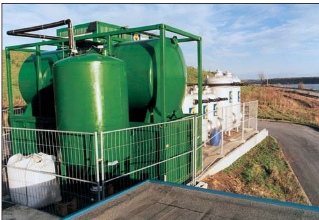
Absetz- und Reinwassertank
