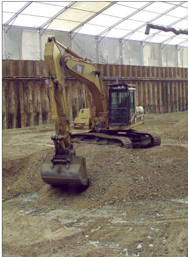
Aufgrund der schadstoffangereicherten und explosionsgefährdeten Atmosphäre musste eine leistungsstarke Bewetterungsanlage eingesetzt werden. Die Reinigungsanlagen waren auf Durchsätze von 90.000 m 3 /h für die Abluft und 20 m 3 /h für das Grundwasser ausgelegt.
