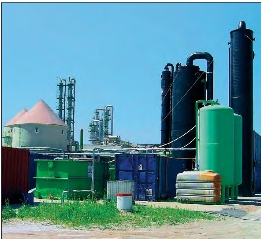
Der Pilotbetrieb erforderte eine anpassungsfähige Wasserreinigungsanlage, die flexibel gesteuert werden konnte, um zahlreiche Kenndaten für die Ausschreibungsplanung der Langzeitanlage zu ermitteln.
