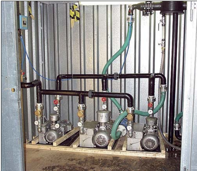
Die Anlage besteht aus den ATEX-konformen Vakuumerzeugern sowie den Bioslurping-Schlürflanzeln und einer Luftaktivkohleadsorptionsanlage zur Reinigung der Abluft.
