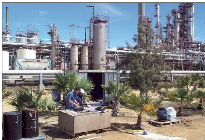
Die Vakuumverdichter und die Abluftreinigungsanlage sind ATEX-konform und klimagesichert in einem Container montiert.
