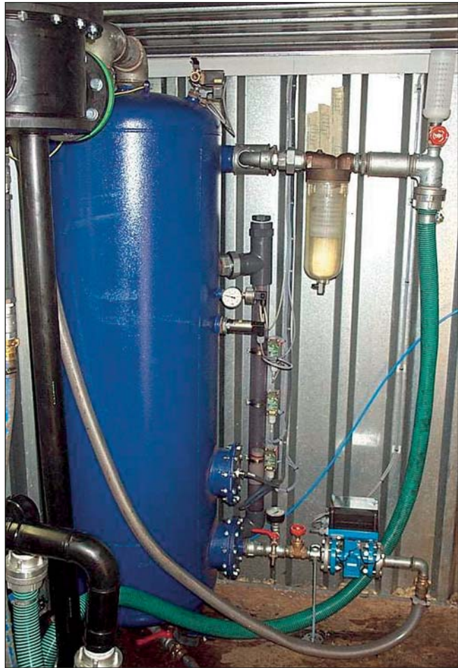
Das im Wasserabscheider angesammelte kontaminierte Grundwasser wird automatisch ausgetragen und über eine Wasseraktivkohleanlage gereinigt. Der Phasensammeltank verfügt über eine Füllstandserfassung, die bei Überfüllung automatisch einen Anlagenstopp auslöst.
