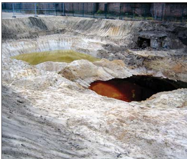
Da feiner Sand ansteht, befinden sich in einer Baugrube sanierte, kontaminationsfreie Bereiche direkt neben aufschwimmender Ölphase.
