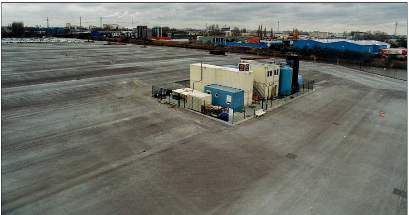
Ansicht der Wasserreinigungsanlage auf dem eingekapselten und oberflächenversiegelten Areal
