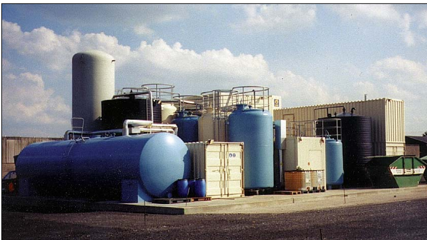
Die Wasserreinigungsanlage ist vorerst fünf Jahre in Betrieb
