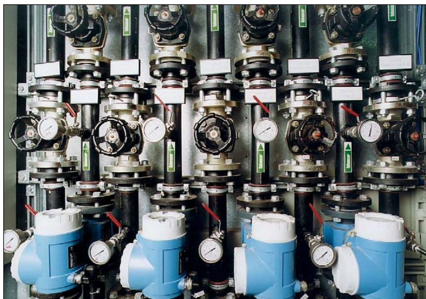
Detail aus dem Pumpen- und Armaturencontainer
