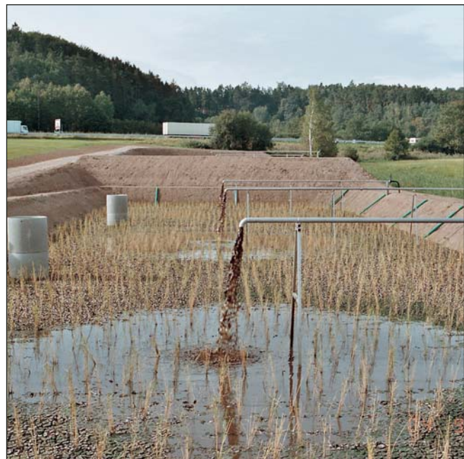
Das Vererdungsbeet 2 wird mit Klärschlamm beschickt. Die gesamte Beetfläche ist bereits mit stark entwässertem Klärschlamm bedeckt, der von Trockenrissen durchzogen ist. Im Hintergrund das 3 m höher gelegene Vererdungsbeet 3 und die Autobahn A3.
