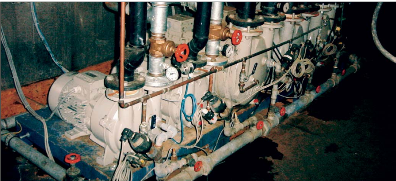
Zwei Wasserringvakuumpumpen saugen Pegelluft an und führen sie dem Katalysator zu. Die anderen drei Pumpen erzeugen den für die Stripplung notwendigen Unterdruck in den Türmen.
