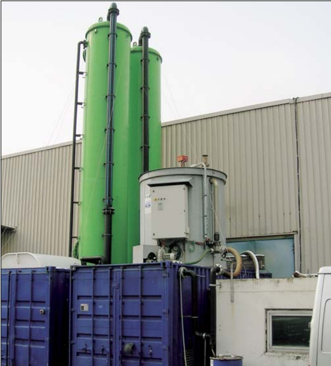
Bei der Sanierungsanlage überragen die zwei Vakuumstripptürme mit einer Höhe von 10 m die Anlagencontainer und die vier Lösemitteltanks deutlich. Die katalytische Oxidationsstufe findet in einem Edelstahlbehälter statt.
