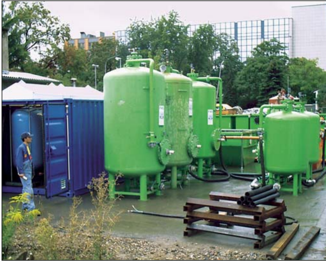
Die Grundwasserreinigungsanlage besteht aus einer Vorsedimentation, einer Filterstufe aus zwei manuell rückspülbaren Zweischichtfiltern, einer Wasseraktivkohlestufe, sowie nachgeschalteten Ionenaustauschern zur Entfernung der Cyanide.
