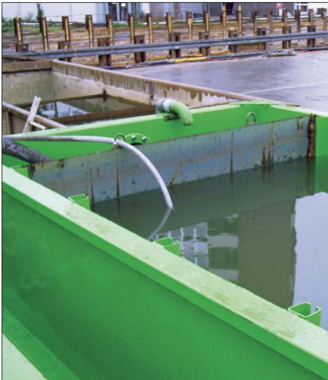
Das gereinigte Wasser wird je nach Witterung in den Regenwasserkanal oder in den Mischwasserkanal eingeleitet.
