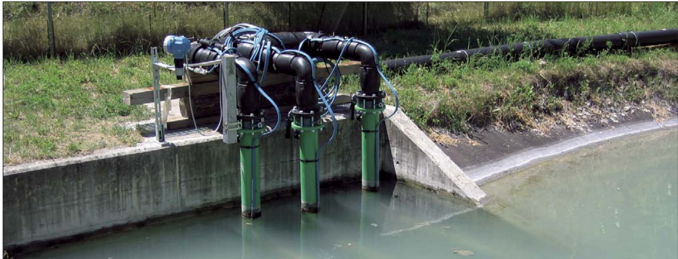
Je nach Wasserstand ist eine verschiedene Anzahl von Pumpen aktiv, um das Wasser aus dem Pufferbecken in die Nitritaufbereitungsanlage zu pumpen. Gesteuert wird die Pumpanlage von einer Ultraschall-Niveaueüberwachung.
