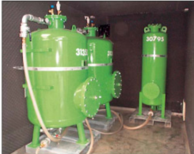
Die Sanierungsanlage für gelöste Schadstoffkonzentrationen wurde in einem konventionellen Frachtcontainer montiert und hat eine Durchsatzleistung von 5 m 3 /h.
