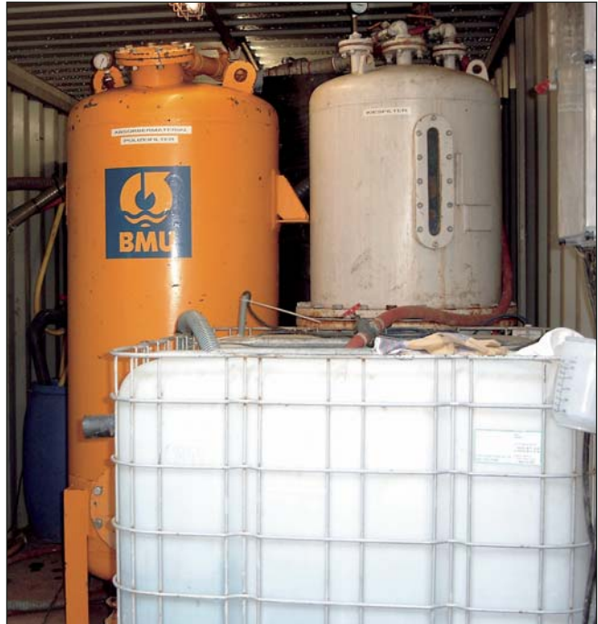
Die Anlage besteht aus den Stufen Chromatreduktion, Fällung und Flockung, Sedimentation, Filtration im Kies- sowie Absorberfilter und Abreinen der LHKW's in Wasseraktivkohlefiltern.
