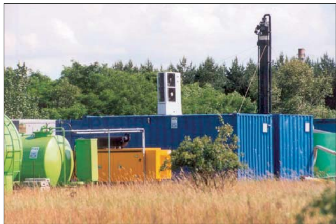
Die Grundwassersanierungsanlage im Bereich des Haupttanklagers besteht aus einem Produktsammeltank, KatOx-Anlage zur Abluftreinigung und Strippanlage zur Kondenswasseraufbereitung.
