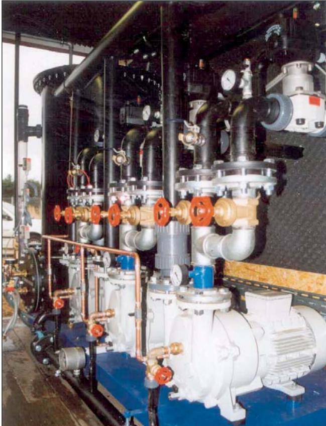
Die ATEX-konformen Wasserring-Vakuumpumpen zur Bodenluftabsaugung arbeiten mit Unterdruck, der direkt am Brunnenrohr angelegt wird.
