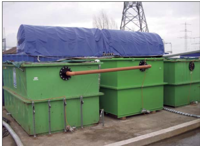
Die Aufbereitungsanlage besteht aus Koaleszenzabscheider, Schrägklärer, Rückspülwasserbecken und einer eingehausten Filterstrecke mit zwei Sand- und zwei Aktivkohlefiltern und ist für eine Abreinigung von 10 m 3 /h ausgelegt.
