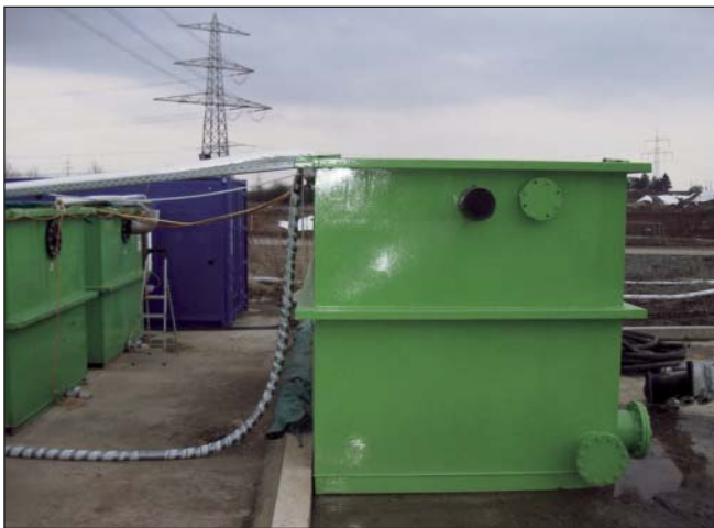
Die Sandfilter der Reinigungsanlage werden zeit- bzw. druckgesteuert rückgespült. Der in einem Becken anschließend abgesetzte Rückspülschlamm wird bis zur späteren Entsorgung im Schlammstammeltank (rechts) zwischengepuffert.
