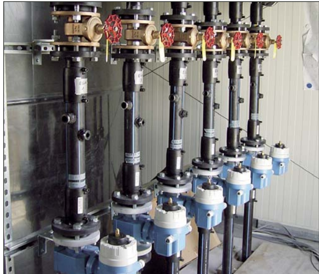
Das Rohwasser wird aus sechs Entnahmebrunnen gefördert. Jeder Strang verfügt im fertiggestellten Zustand über ein magnetisch-induktives Durchflussmessgerät, Manometer und Drosselschieber sowie einen Probenahmehahn.
