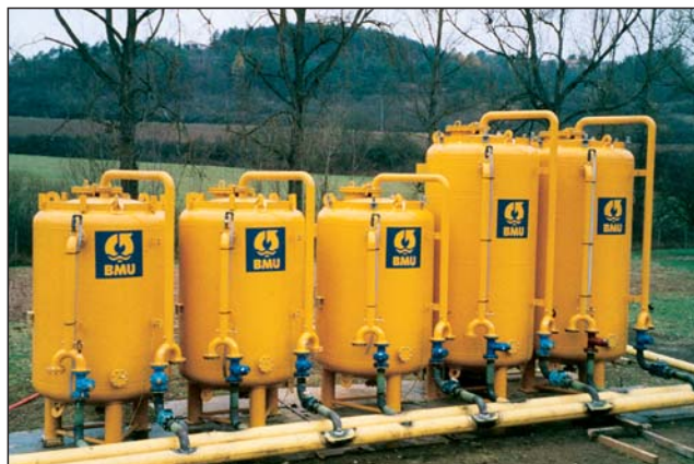
Aufbau und fertiggestellte Wasserreinigungsanlage
