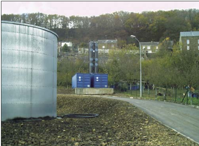
Die Hauptanlage ist in zwei 30-Fuß Schiffscontainern installiert. Die Vakuumbearbeitung ist getrennt davon in einen 10-Fuß Container eingebaut.
