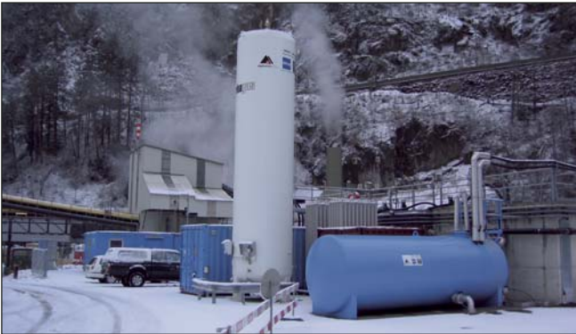
CO 2 -Tank und Brauchwasserbehälter im Vordergrund zur Neutralisation des behandelten Wassers.
