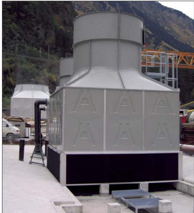
Rieselgitterkühltürme mit Spezialschalldämpfer im Standby-Betrieb.
