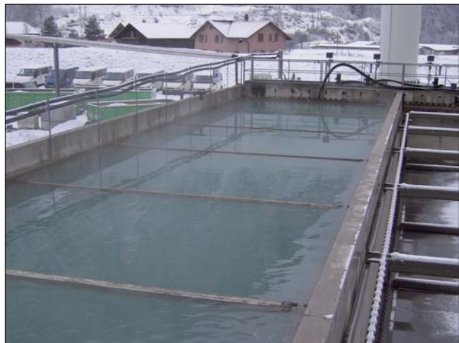
Behandlungsstraße mit Bandräumern zur Feststoffabscheidung.
