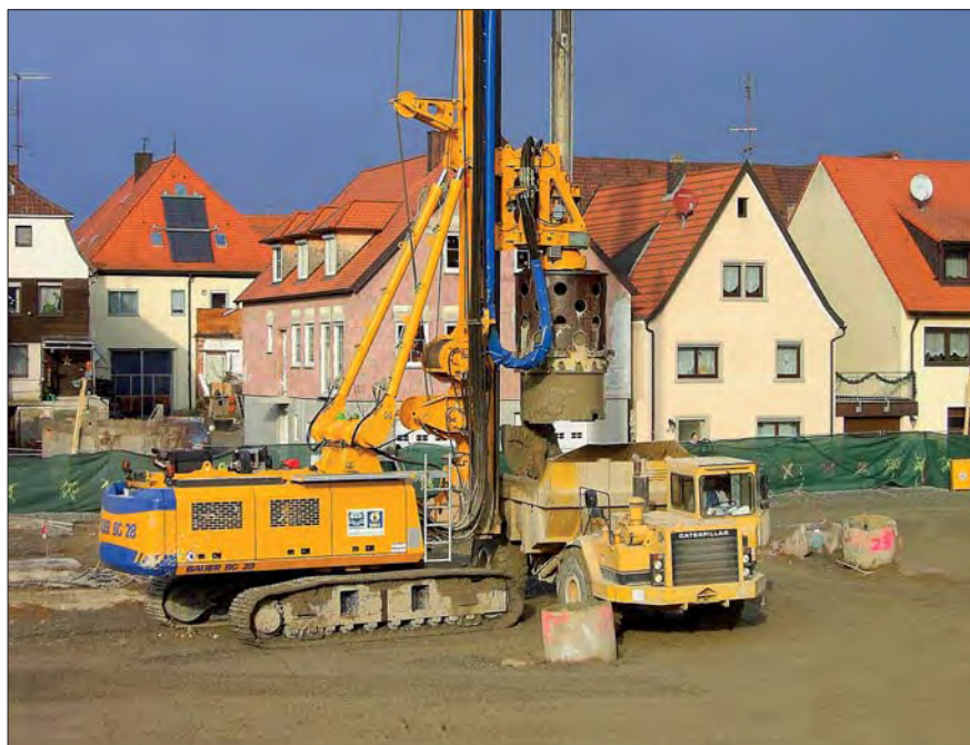
Aufgrund der engen Bebauung und der schwierigen hydraulischen Situation wurde der Boden durch Großlochbohrungen ausgetauscht.
