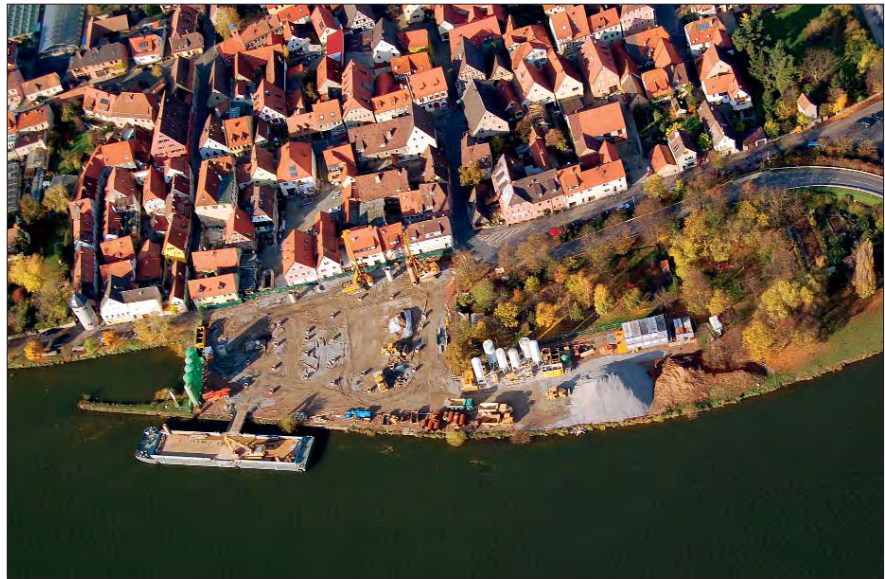
Um die Baustelle Mainländer nicht dem Risiko eines Winterhochwassers auszusetzen, wurde kurzfristig ein zweites Großbohrgerät aufgegeben. Beide Geräte waren an 6 Tagen in der Woche im Einsatz.
