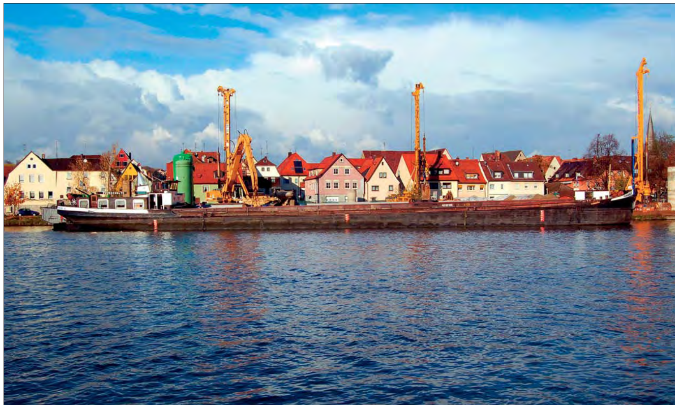
Um Beeinträchtigungen der Bevölkerung durch Schwerlastverkehr zu vermeiden, wurde zur Baustellenversorgung eigens eine Schiffsanlegestelle errichtet.
