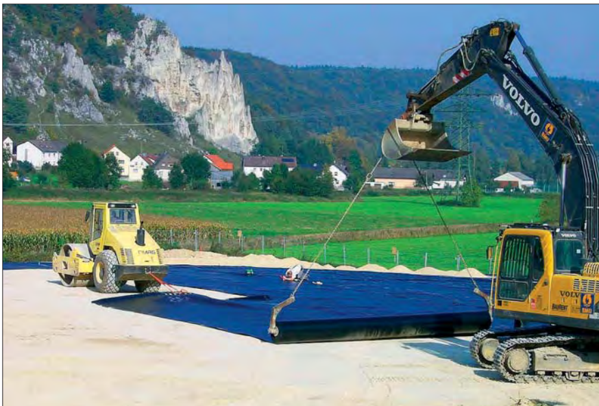
Basis der mehrschichtigen Oberflächenabdichtung ist eine 2,5 mm starke HDPE Folie, deren Bahnen miteinander verschweißt und anschließend auf Dichtigkeit geprüft wurden.
