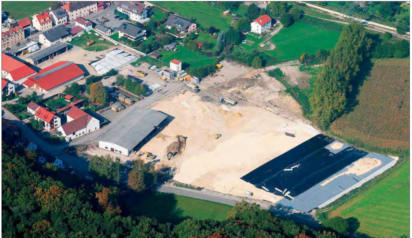
Auf dem Gelände der ehemaligen Glashütte „Phönix“ wurden insgesamt 22 Gebäude mit einem umbauten Raum von 62.000 m 3 abgebrochen. Die freie Oberfläche wurde mit einer mehrschichtigen Abdichtung gegen Einträge ins Grundwasser gesichert.
