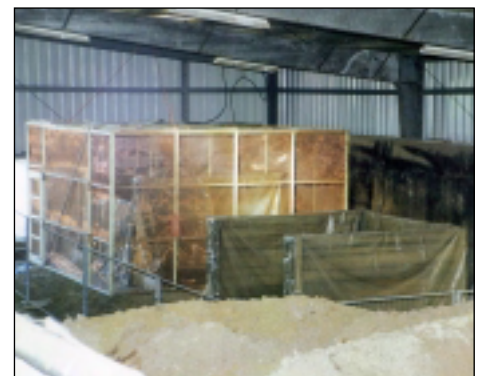
Anlage zur thermisch unterstützten mikrobiellen Bodensanierung in der Bodensanierungsanlage Hirschfeld (Bauer & Mourik Umwelttechnik/BMU)
