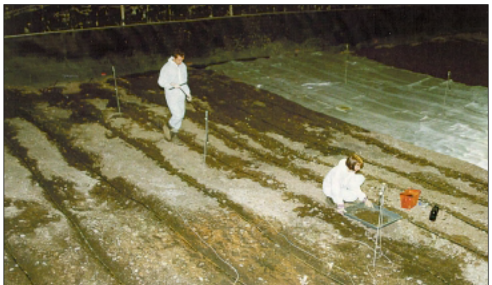
Behandlungsbecken in der Bodensanierungsanlage Hirschfeld
