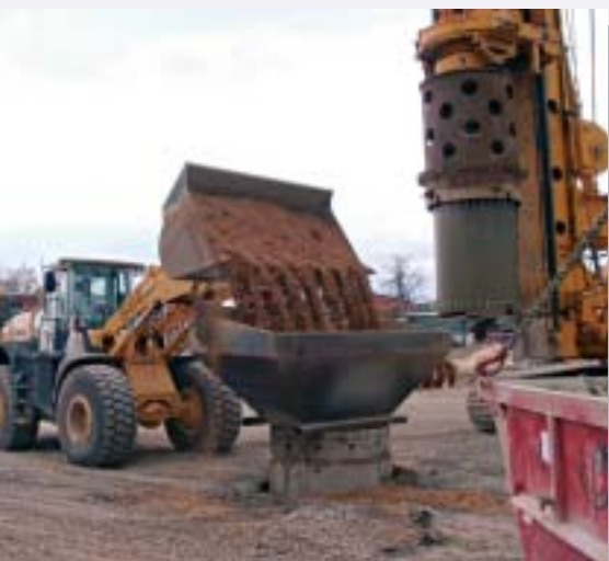
Die Bohrungen wurden nach dem Aushub des kontaminierten Materials bei gleichzeitigem Ziehen der Verrohrung mit unbelastetem Material verfüllt.
