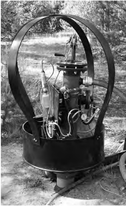
Förderbrunnen mit lokalem Phasenabschöpfsystem
