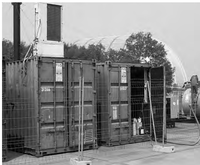
Die Grundwasser-sanierungsanlage am Zwischentanklager besteht aus Produktsammeltank, KatOx-Anlage zur Abluftreinigung und Strippanlage zur Kondensatwasseraufbereitung
