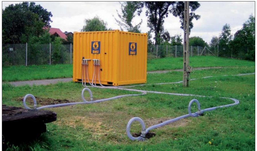
Zur in-situ Sanierung wurden mehrere Pegel errichtet, die der Belüftung des Untergrundes mit Frischluft dienen. Zusätzliche Nährstoffgaben steigerten die Abbautätigkeit der natürlich im Untergrund vorhandenen Mikroorganismen.
