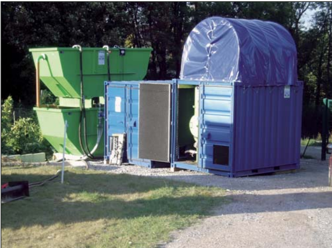
Zwei in Serie geschaltete Stripp-Einheiten bilden das Kernstück der Grundwasserreinigungsanlage. Zudem sind Ölphasenabscheider und mehrere Filtermodule installiert.
