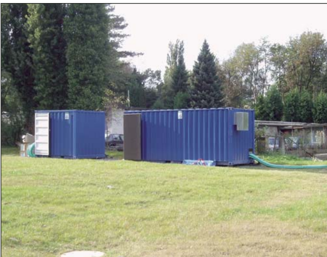
Die in Containern installierte Bodenluftabsauganlage besteht aus einem Wasserabscheider und Aktivkohlefiltern.
