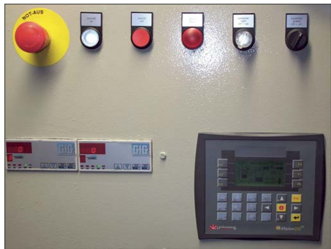
Die gesamte Steuerungseinheit ist in einem separaten Container untergebracht. Damit konnte in diesem Bereich der Aufwand für den Explosionsschutz wesentlich reduziert werden.
