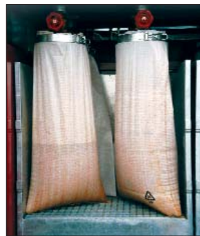
Sackanlage und katalytische Oxidation
