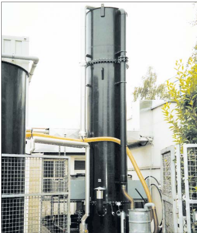
Strippung der leichtflüchtigen Schadstoffe
